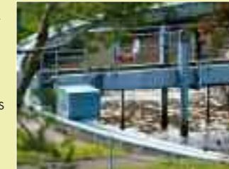
Biogas: Im Klärschlamm steckt Kraft für Strom und Heizung.
