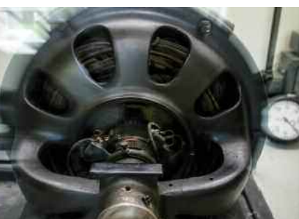
Historischer Generator: 100 Jahre und weiter im Dauerbetrieb.
