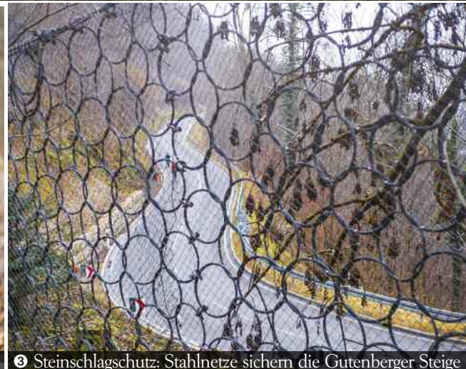
❸ Steinschlagschutz: Stahlnetze sichern die Gutenberger Steige
